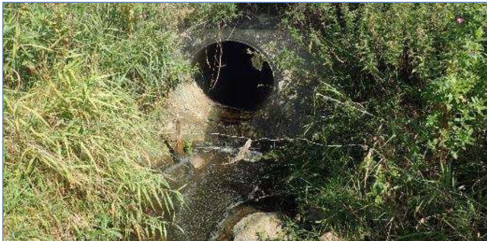
Bæk i Kjærdal/Prebengårds Bæk ved afslutningen af strækning B hvor vandløbet krydser Mejerivejen, som med et frit fald udgør en spærring for faunaen. Den lave vandføring ses tydeligt.
